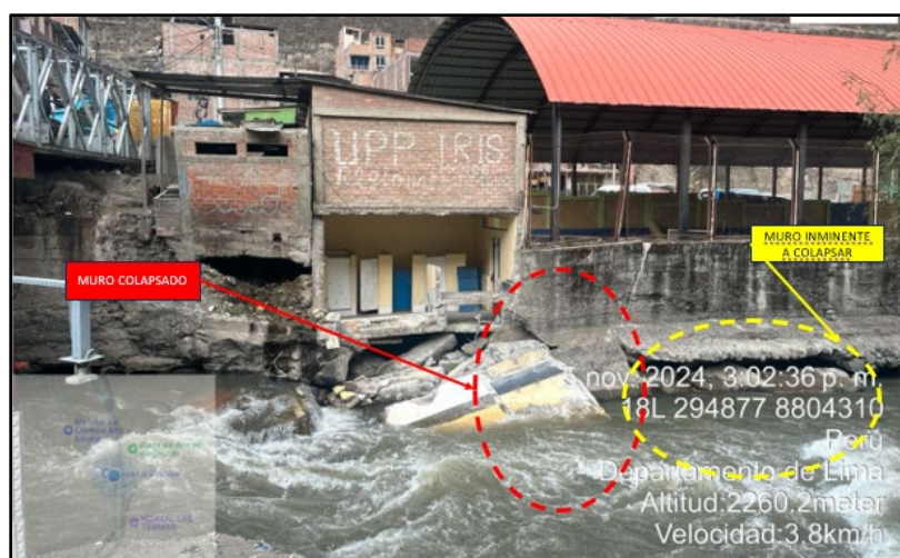
Figura N°4 Colapso de Muro
